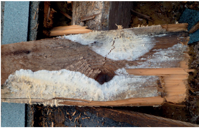
Befall mit Holzpilz an Unterseite Dachschalung, Feuchte durch Kondensation
