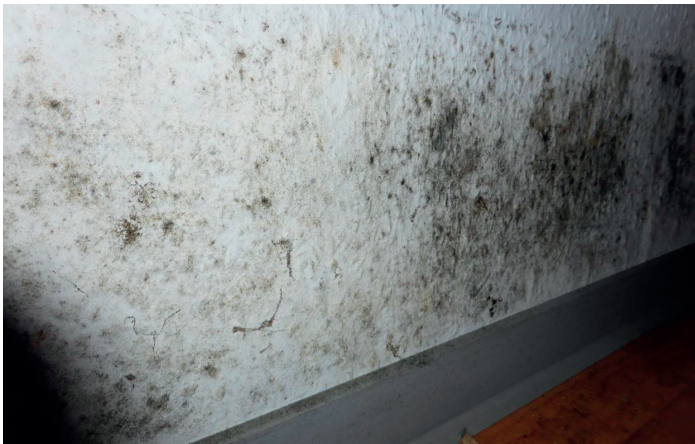
Schimmelpilze auf der Wandoberfläche
