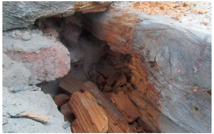
Zerstörung des Balkenauflegers durch Braunfäule
