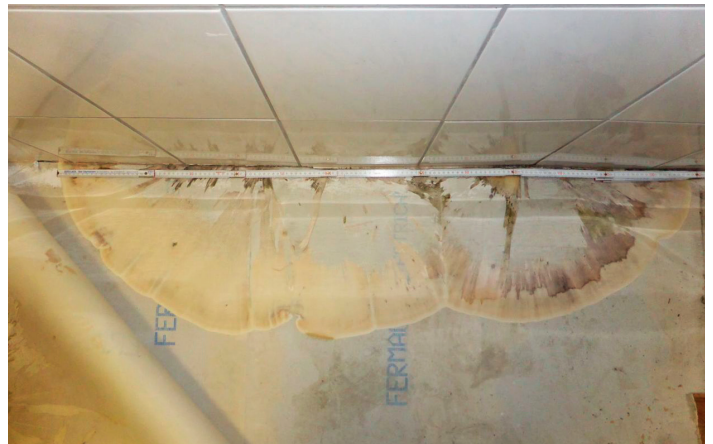
Echter Hausschwamm wächst unter Fußbodenbelag
