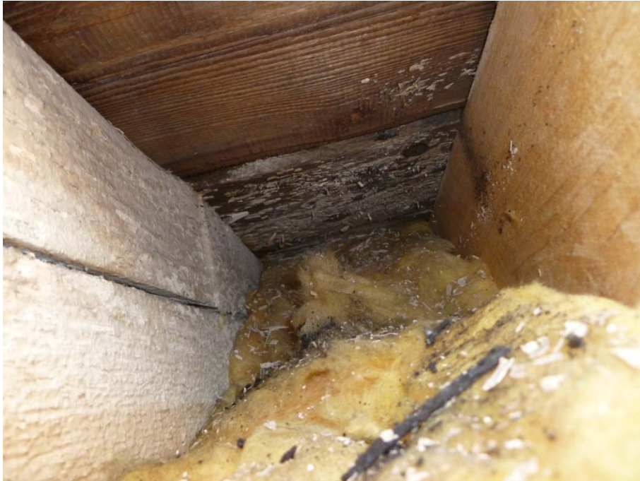
Feuchteränder und Schimmel an Dachschalung sichtbar
