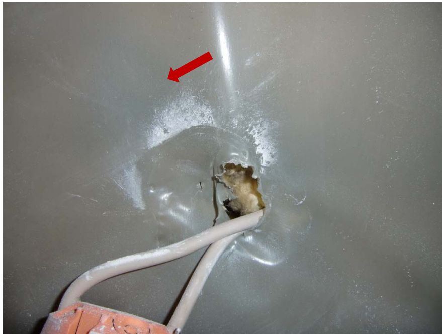
Durchdringung Dampfbremse mit ELT-Kabeln - undicht
