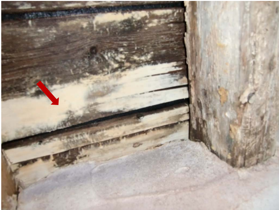
Mycel von Holzpilzen an Brettschalung unterseitig – WHG Godehardt
