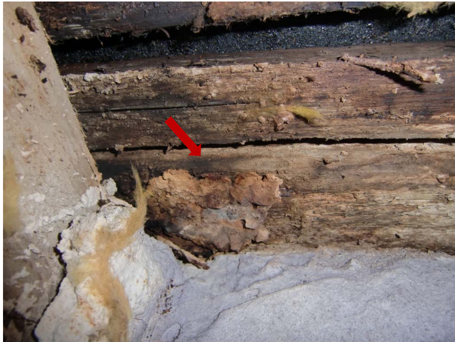
Pilzbefall und Feuchteränder an Holzbauteilen sichtbar (aktiver Befall)
