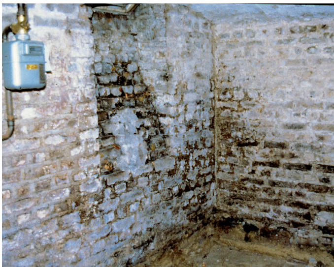
So sehen Keller häufig aus: feucht, an den Wänden Schimmelpilz oder Hauschwamm. In diesem Zustand können die Räume nicht genutzt werden. Weiteres Problem: die Bausubstanz wird nachhaltig geschädigt. FOTO: GETIFIX
