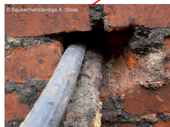
Durchführung nicht verschlossen, alte Leitung nicht entfernt. Fotos: Gross
