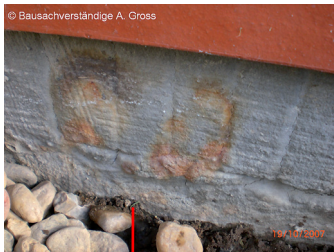
Risse bilden sich auf den Steinvertiefungen – es fehlt die Egalisierung.
