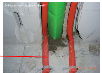
Dämmschlauch über Rohren schon montiert jedoch keine Rohrabdichtung vorhanden.
