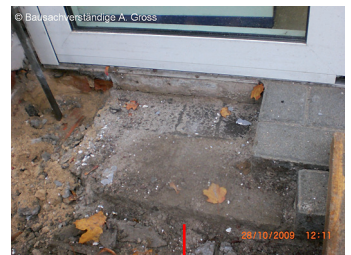
Keine Abdichtung unter dem Fensterelement hinter dem Betonpflaster vorhanden.
