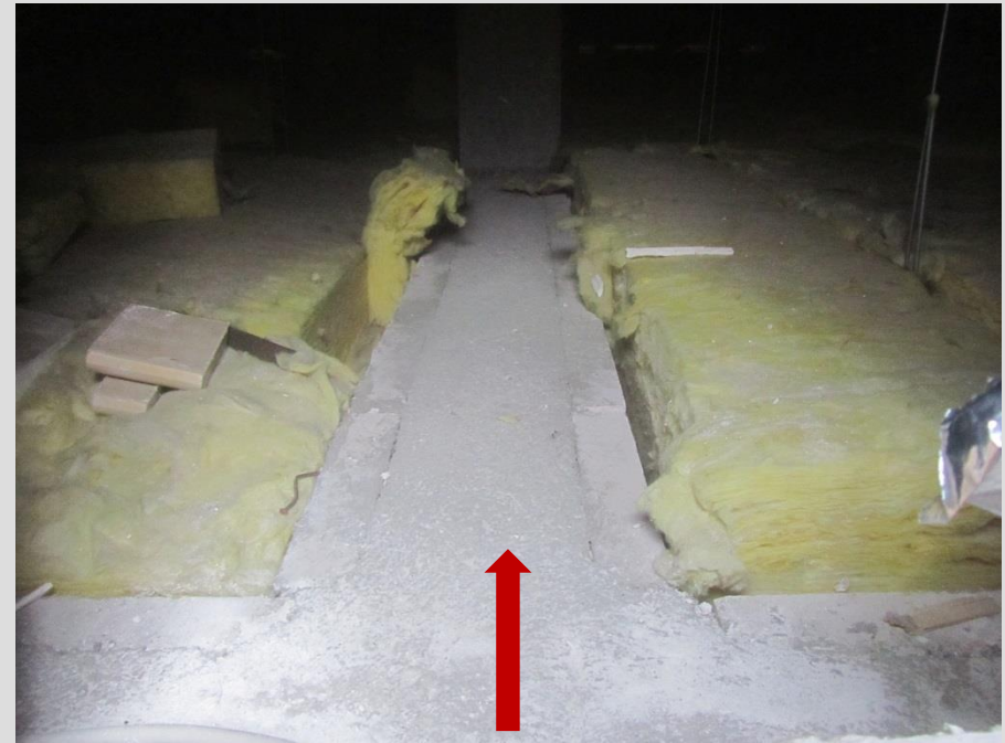
Dachraum: obere Wandanschlüsse Ringbalken nicht gedämmt
