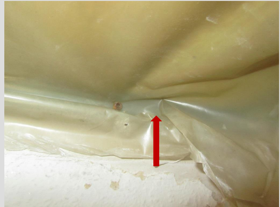
Keine Befestigung der Dampfsperre am Mauerwerk
