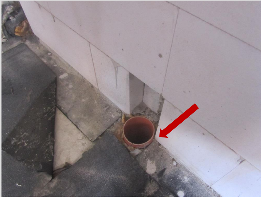
Bodenplattendurchdringung Abdichtung unmöglich
