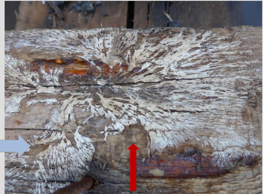
Oberseite des Balkens und Brettschalung Befall mit weißem Porenschwamm (2010)
