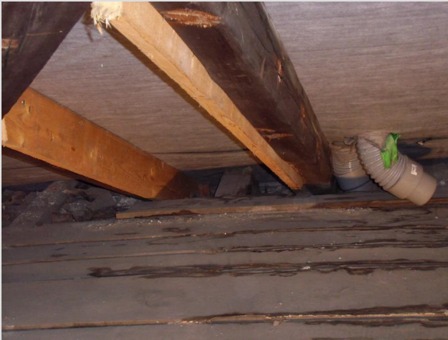
Keine Dampfbremse: Wasserdampfkondensation an den Dielen im Dachboden
