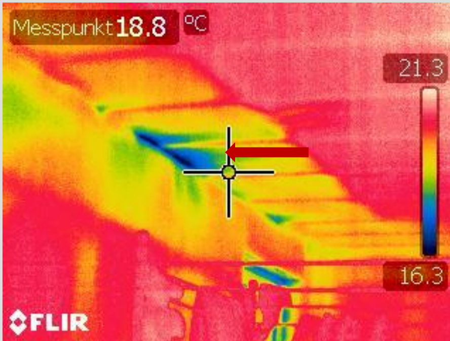
Wärmebrücke an Wand, möglicherweise im Zusammenhang mit Tauwasser
