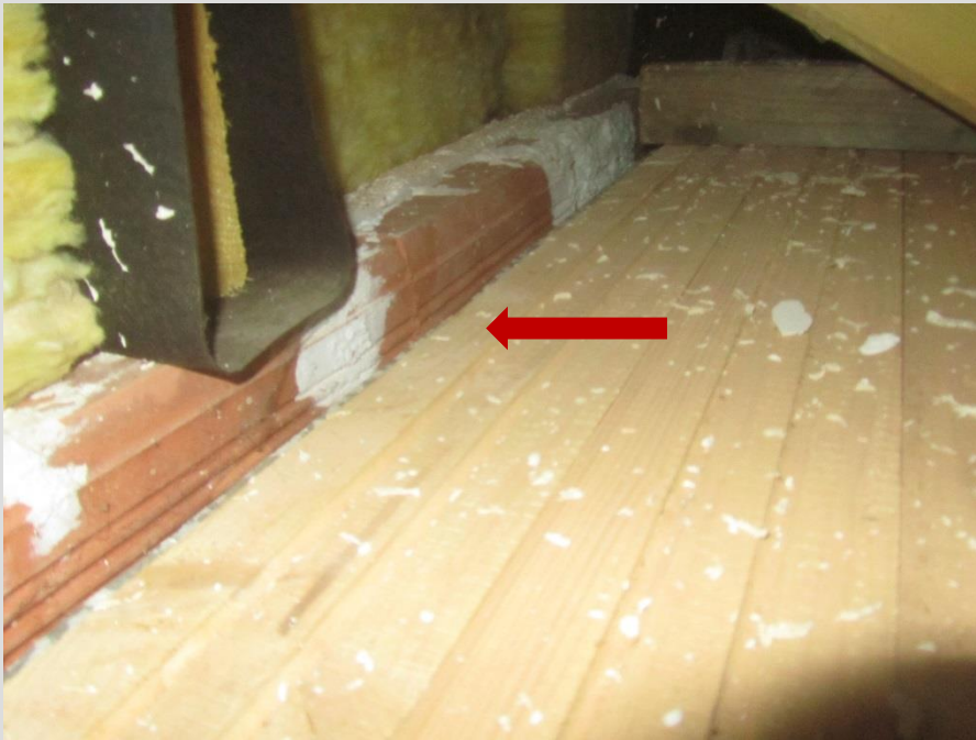
Dämmung Fassade endet unter dem Traufkasten, oberer Abschluss der Wand ungedämmt
