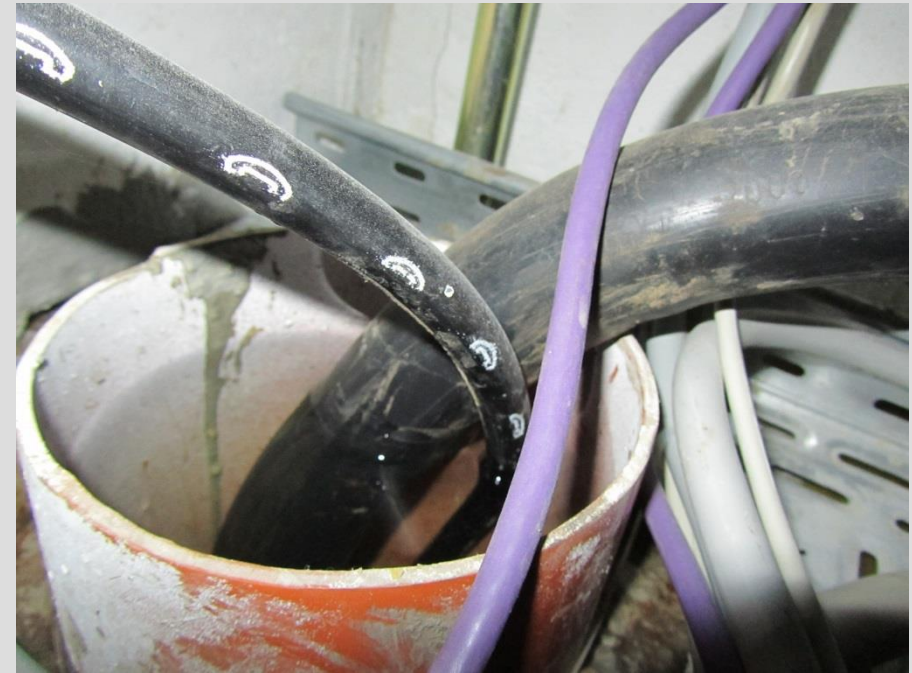
Bodenplattendurchdringung – artesischer Brunnen – so gewollt?
