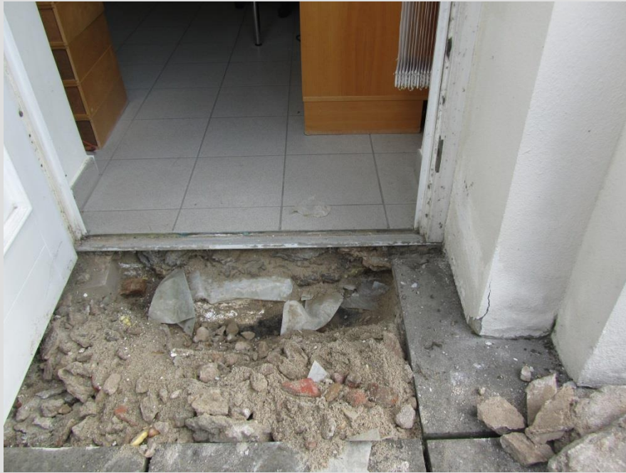
Kein Bauwerksabschluss an Tür, keine Abdichtung
