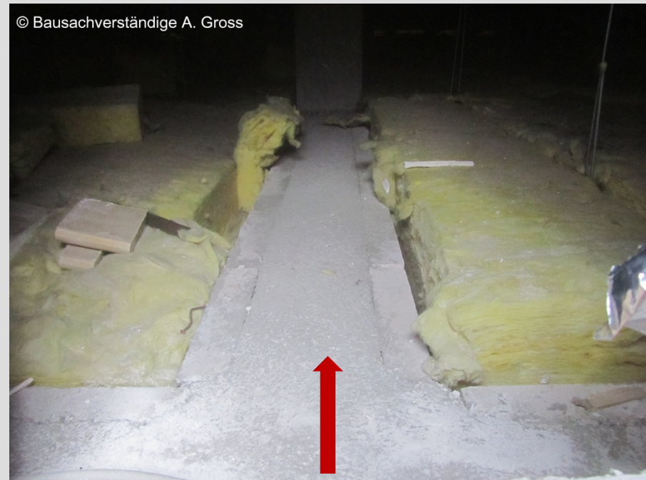
Dachraum: obere Wandanschlüsse Ringbalken nicht gedämmt
