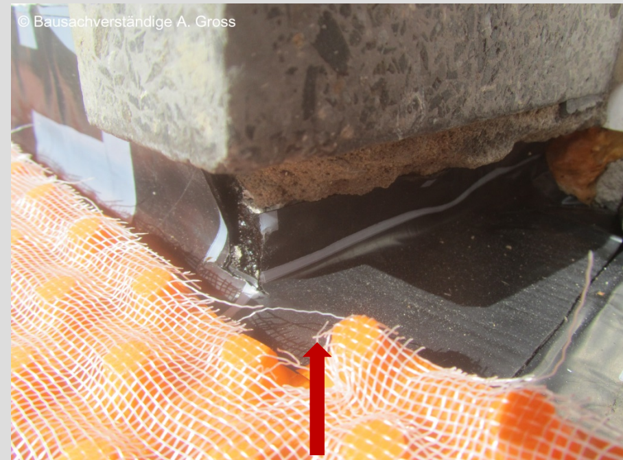
Abdichtung Terrasse ohne Aufkantung, am Fenster offen
