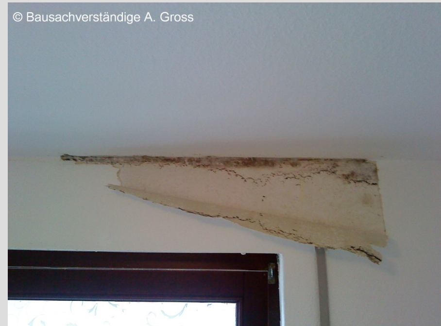
Bad: Dampfsperre nicht dicht verklebt, Feuchte in Deckendämmung und Schimmel
