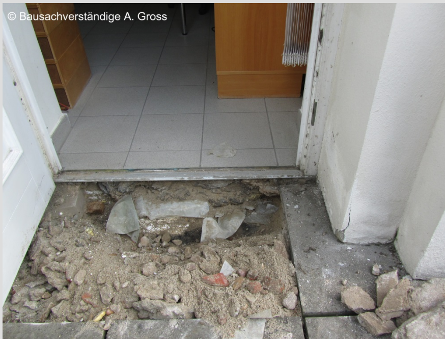
Kein Bauwerksabschluss an Tür, keine Abdichtung
