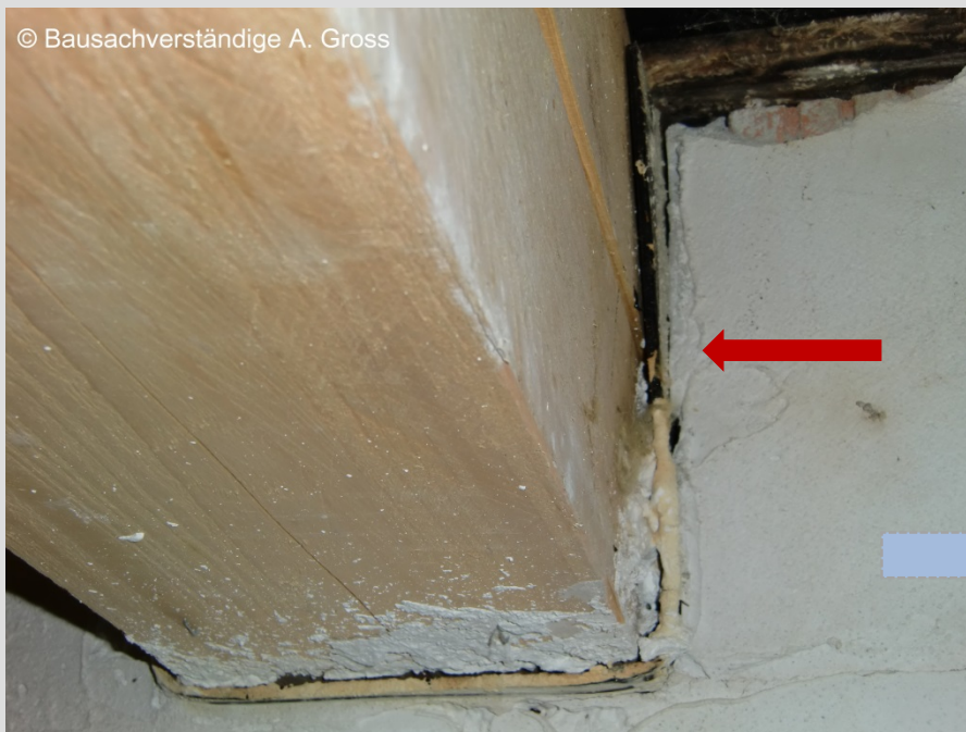
Balkenkopf nicht luftumspült eingebaut (1995) Dampfsperre nicht dicht angeschlossen
