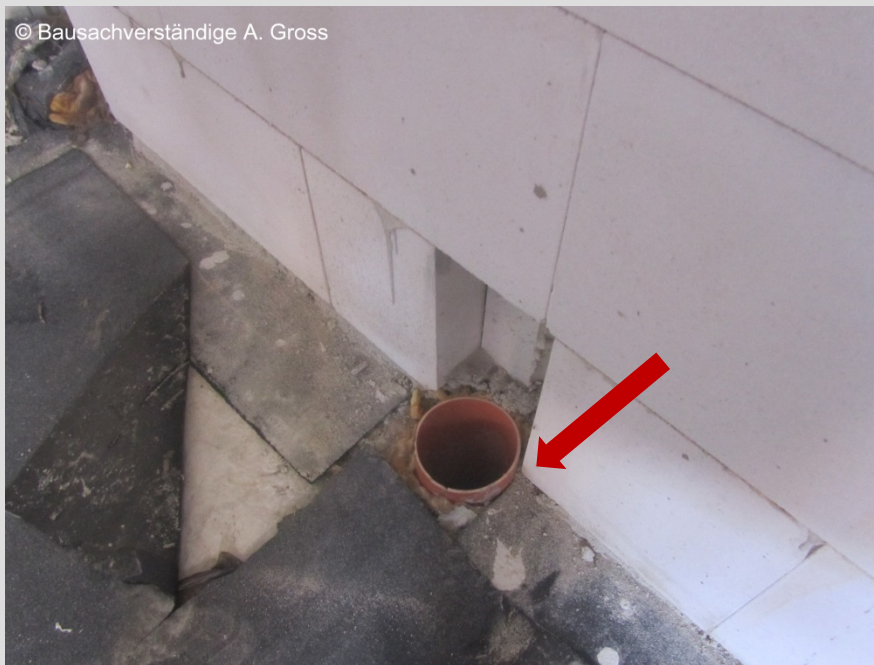
Bodenplattendurchdringung Abdichtung unmöglich
