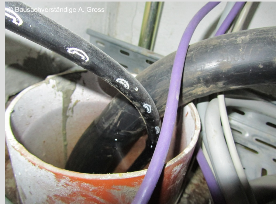
Bodenplattendurchdringung – artesischer Brunnen – so gewollt?
