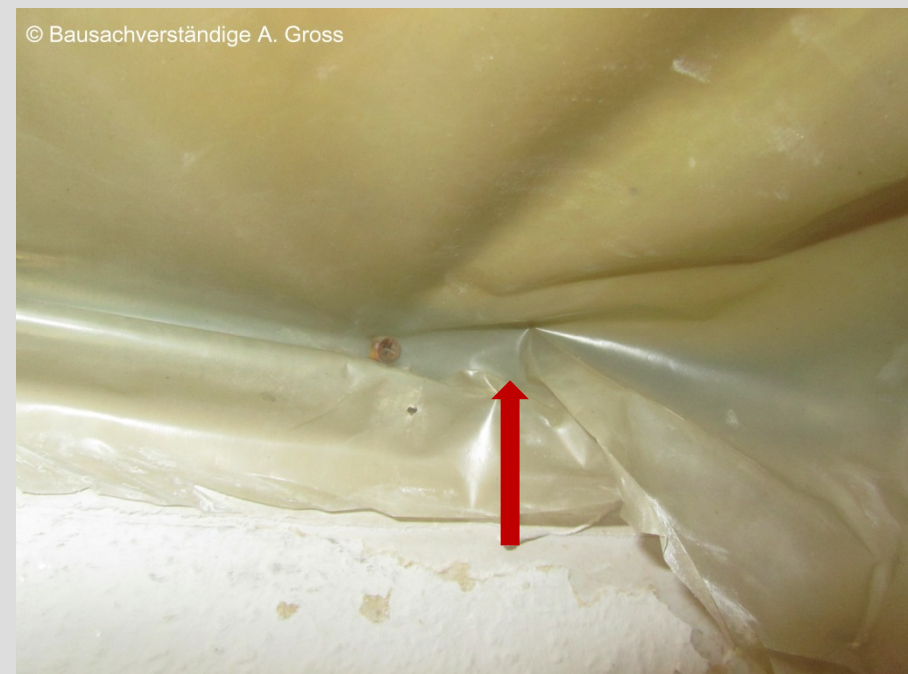
Keine Befestigung der Dampfsperre am Mauerwerk
