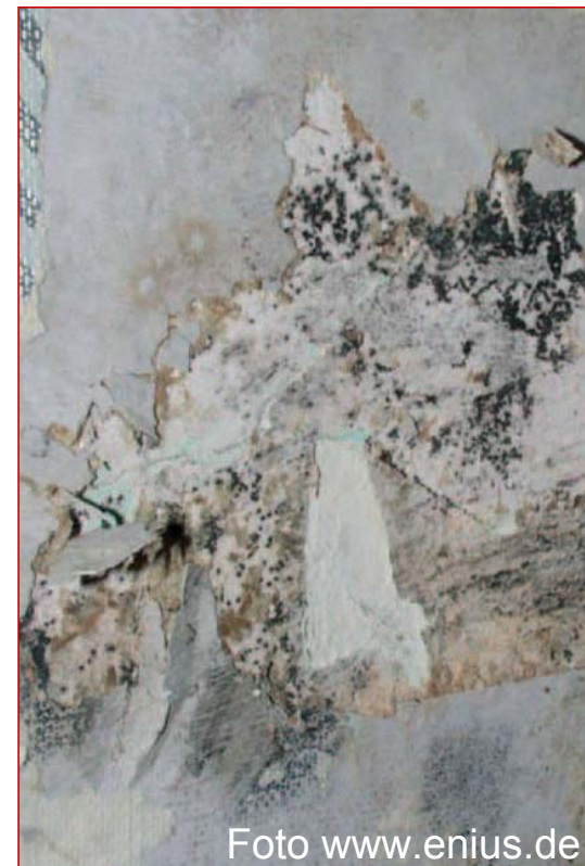
Abb. Schimmelpilz hinter Tapete
