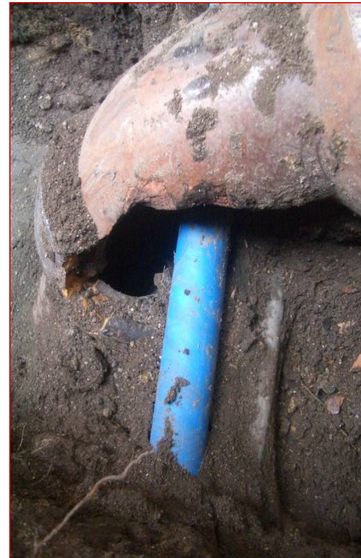
Leckage Grundleitung durch „Schießen“
